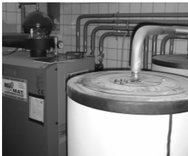
Abb. 1: Holzpellet-Heizung SV Gimweiler (Quelle: eigene Aufnahme).
