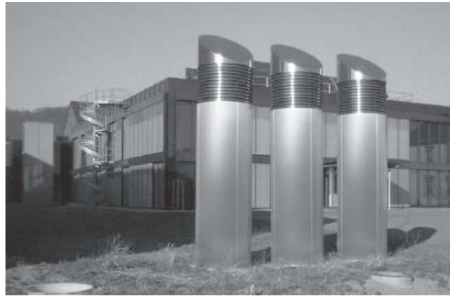
◀ Abb. 3: Teile des Erdkollektors westlich des Zentralen Neubaus
