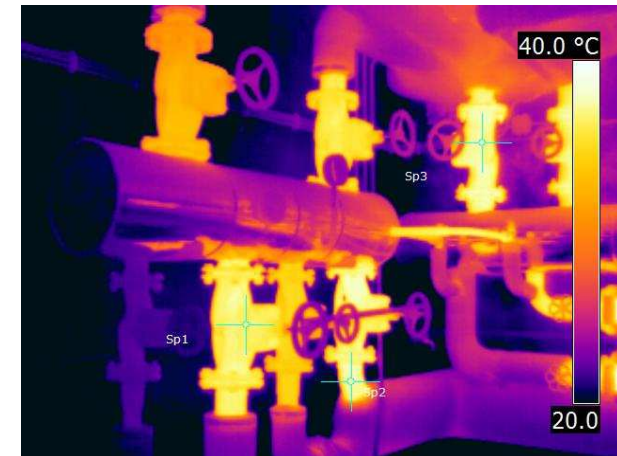
1m nicht isolierte Heizungsleitung entspricht ca. 13-15 l Heizöl/a
